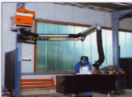
Equipo fijo de filtración con grúa de aspiración
